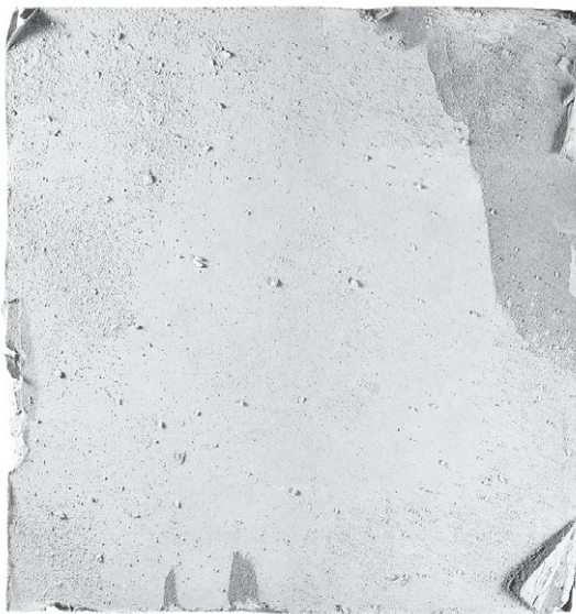
Рис. 10.8. Гипсокартон, поврежденный водой
