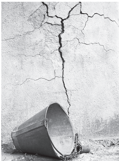
Рис. 4.2. Деформированная, непригодная штукатурка
