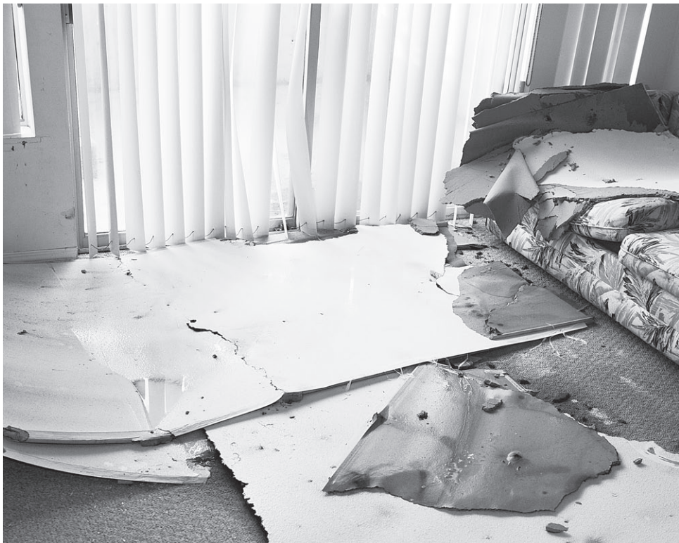
Рис. 10.7. Наибольшую угрозу гипсокартонным конструкциям представляет вода
